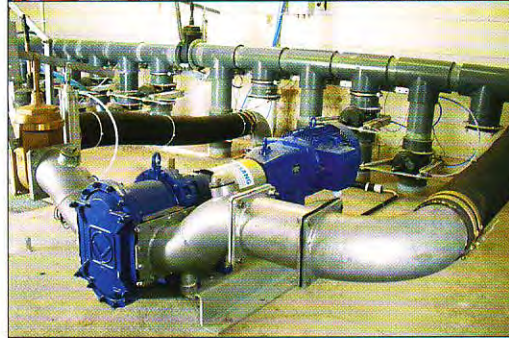
Zentrale Pumpstation mit Getriebemotor. Trocken aufgestellt, gut zugänglich für Service und Wartung.
