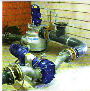
Stationär: Pumpe und RotaCut®-Zerkleinerer
